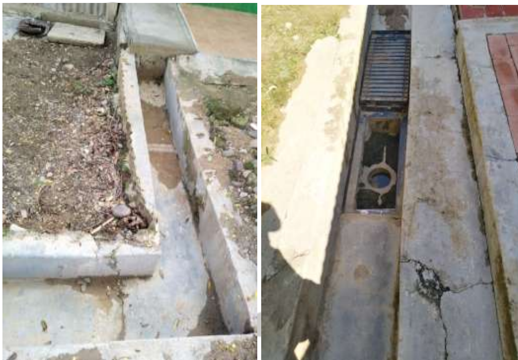
Fotos: Cuneta alto deterioro, empozamiento del agua y mal construida.
