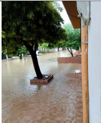
15. Agua acumulada a nivel de andenes y sardineles. Fuente: contratista
