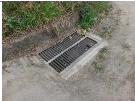
11. Sumideros sin mantenimiento con vegetación y tierra
