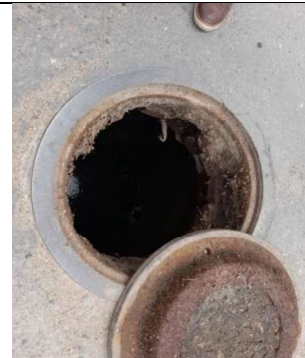
8. Niveles de aguas servidas bastante altos en algunos pozos
