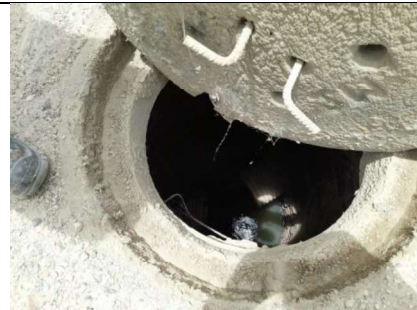
14. Pozo de colegio trabajando a rebose con diferencia de nivel de 1,5 m
