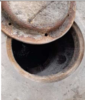
13. En algunos pozos el nivel de aguas servidas supera las cotas claves
