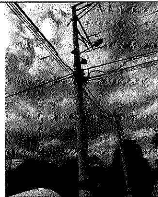
4. Bocinas en postes
